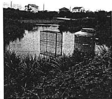
池に水がたまると自動的に運転を開始する排水ポンプ
