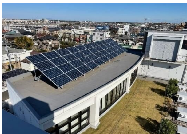
太陽光発電設備（消防本部）
