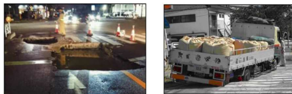
道路陥没の事例
