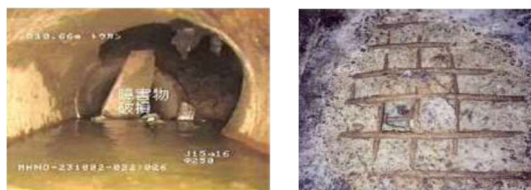
下水道管の老朽化の事例
