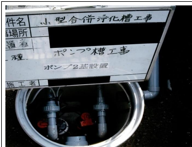
17. ポンプ設備の写真
