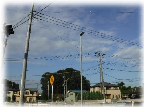
LED 道路照明灯（市道 2 4 号線）
