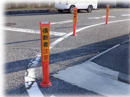
車線分離標（市道 3 7 号線）
