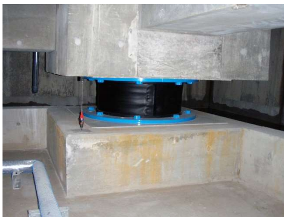
写真-1 免震ゴム (市庁舎)
