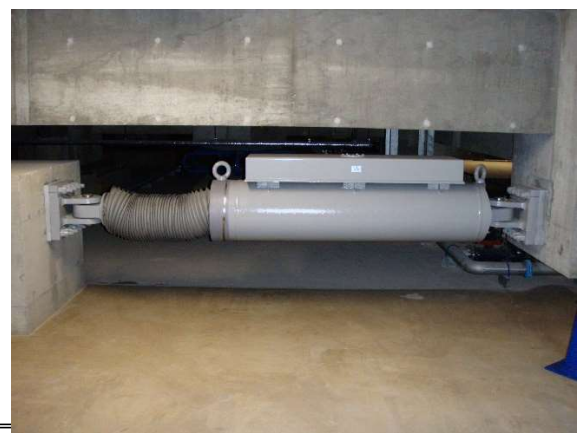
写真-2 オイルダンパー (市庁舎)
